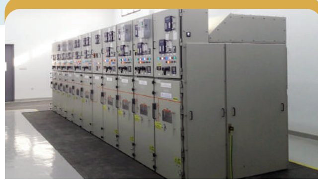
33 KV GIS PANEL
